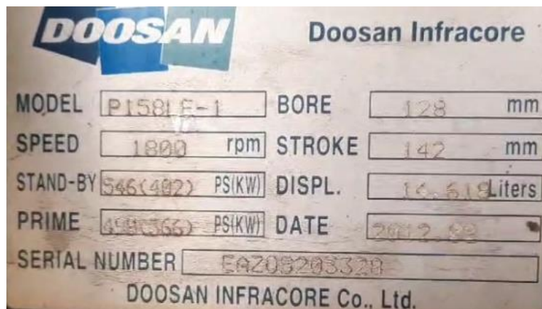
PLACA DE IDENTIFICACION GENERADOR DOOSAN
