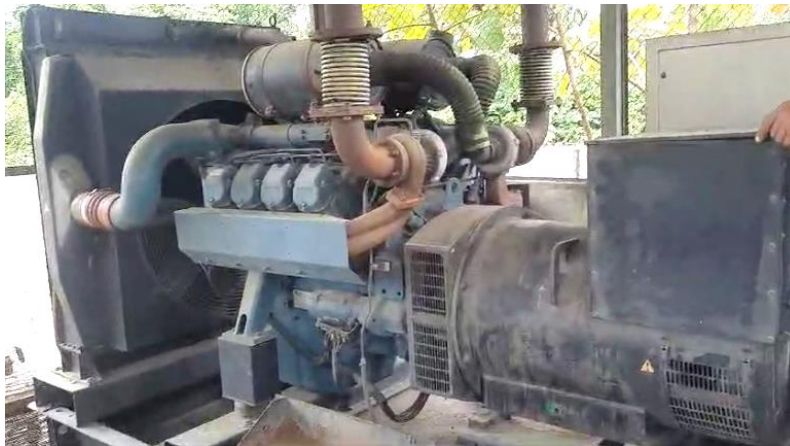
GENERADOR DOOSAN 402KW
